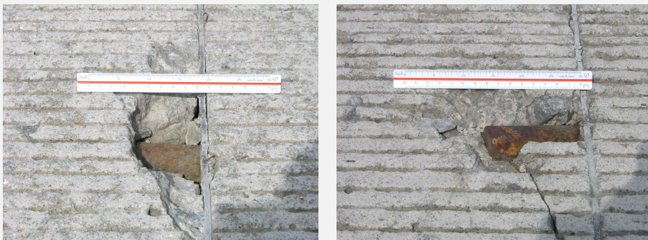
<그림 5.9> 다웰바 시공 불량으로 인한 포장파손(스폴링)
