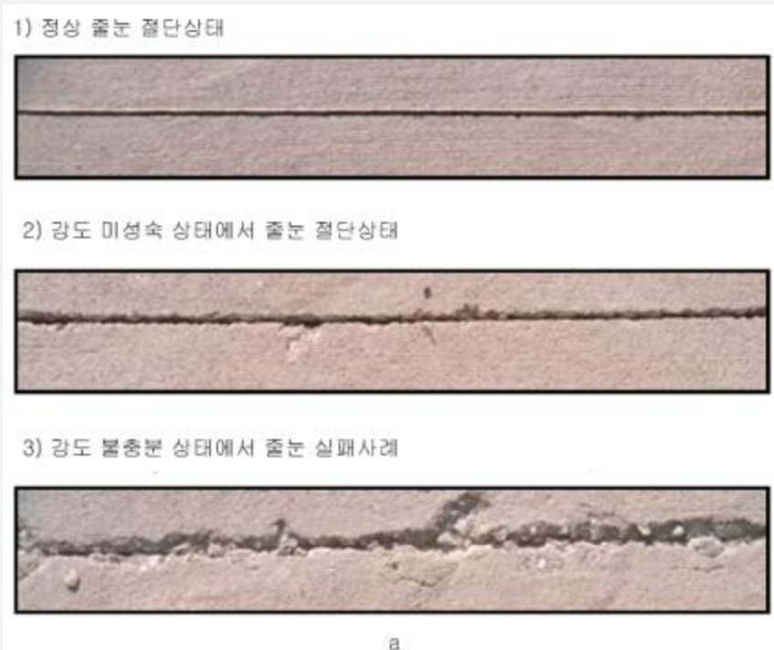
<그림 5.31> 줄눈 절단 시기에 따른 시멘트 콘크리트 표면 형상
