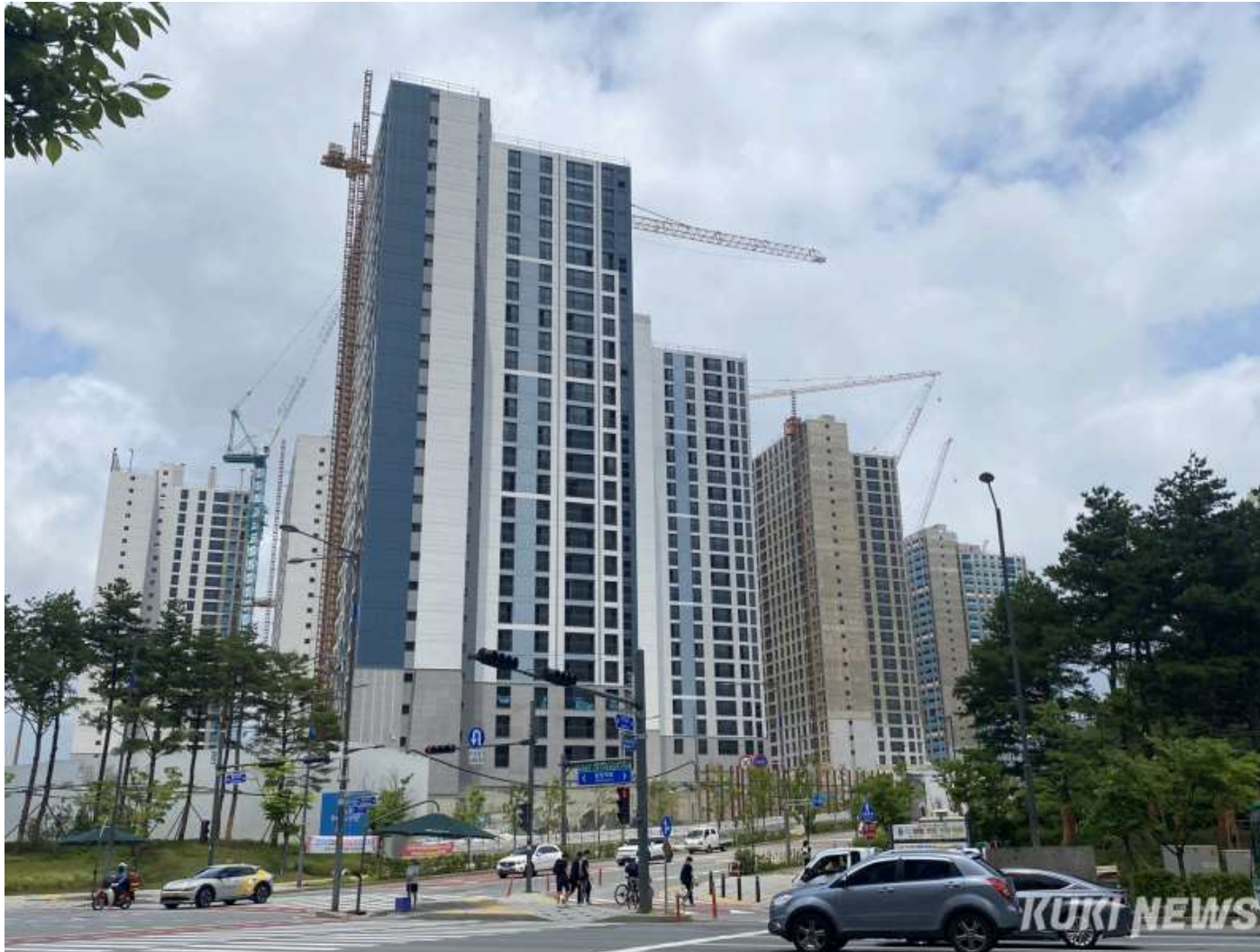
지하주차장 붕괴 사고가 발생한 인천 검단AA13 블록 현장. 쿠키뉴스 자료사진
