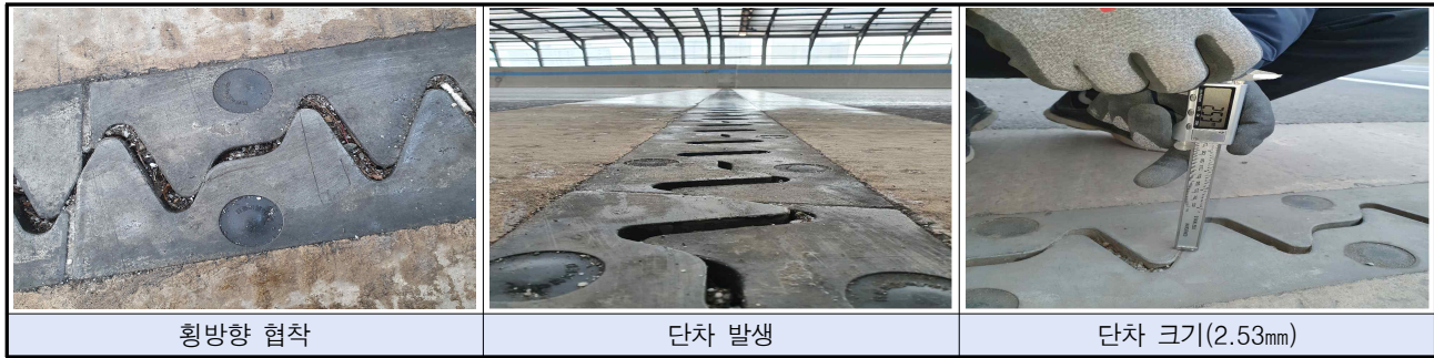
[사진 3] ○ 방향 교대 A2 신축이음장치에 발생한 결함
