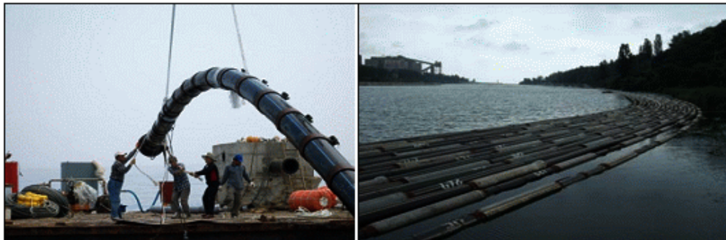
강원 고성 해양심층수 취수 전경
