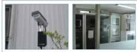
보안장치 설치를 통한 보안효과 극대화 및 입주민 안전 확보
